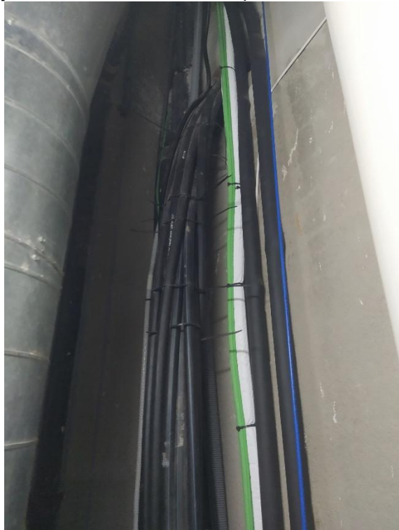
Fotografia 1.6: conjunt de tubs de mostres arribant al laboratori a la planta primera
