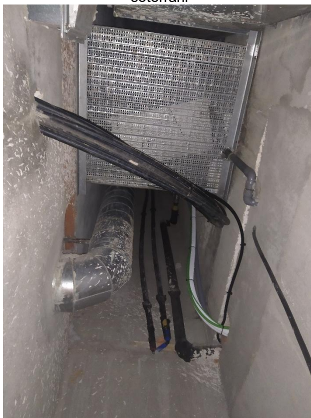
Fotografia 1.4: unió dels tubs al pati d'instal·lacions de la planta soterrani
