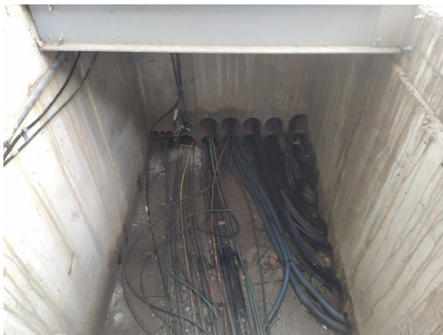
Fotografia 1.2: arqueta amb conduccions al costat de l'edifici de control
